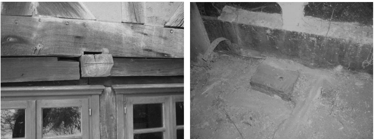
Abbildung 3: (a) Nachträglich eingebrachter Deckenbalken im Wohngiebel. Deutlich sichtbar ist die Ausnehmung in der darüber liegenden Wandschwelle, die beim Einbau des Balkens nicht berücksichtigt wurde, (b) Balkenstummel im Wohngiebel, Innenseite. Schwach erkennbar ist der rechts daneben liegende, später dort eingebaute Deckenbalken.
